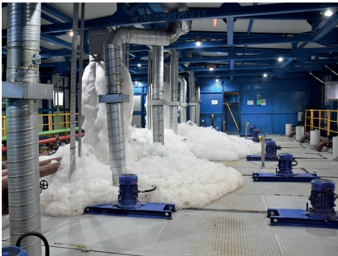
Подача пены из пожарного блок-бокса в емкостной блок
