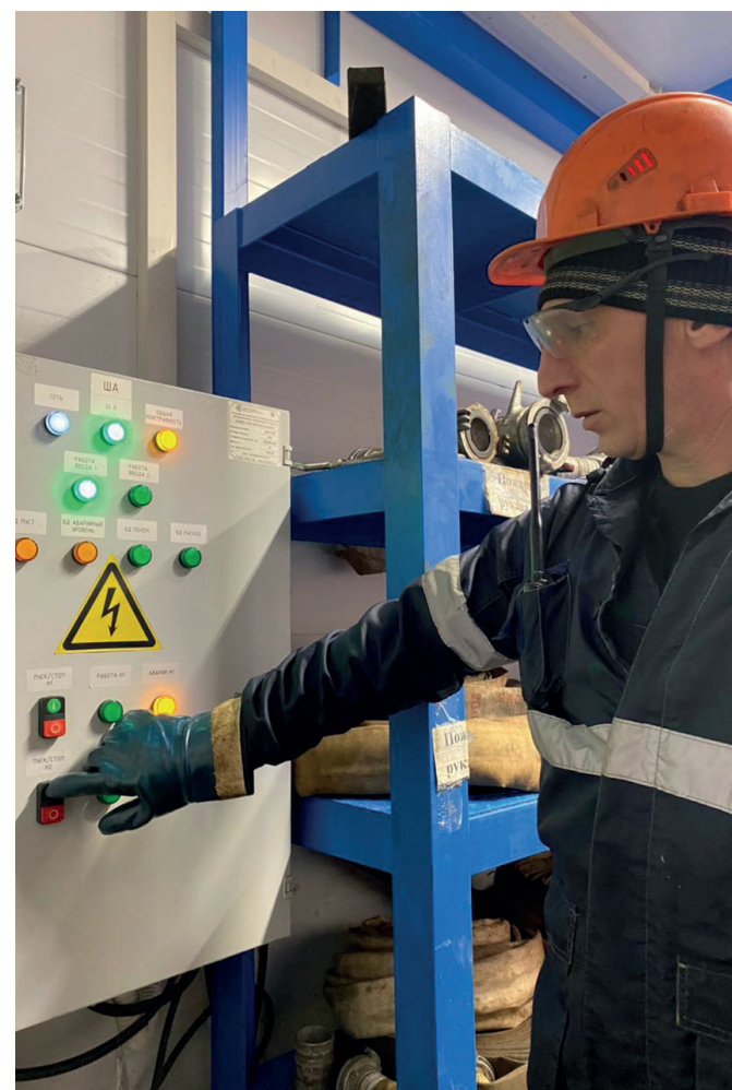
Управление работой насоса для подачи воды на станцию пожаротушения
